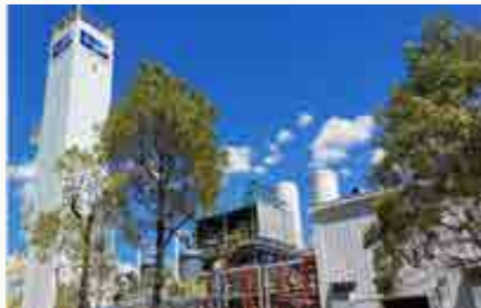
现场制氮节能技改
